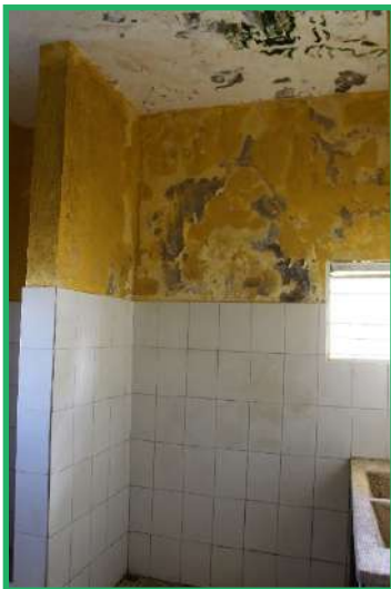
Vista de los baños, nótese el deterioro a causa de filtración
