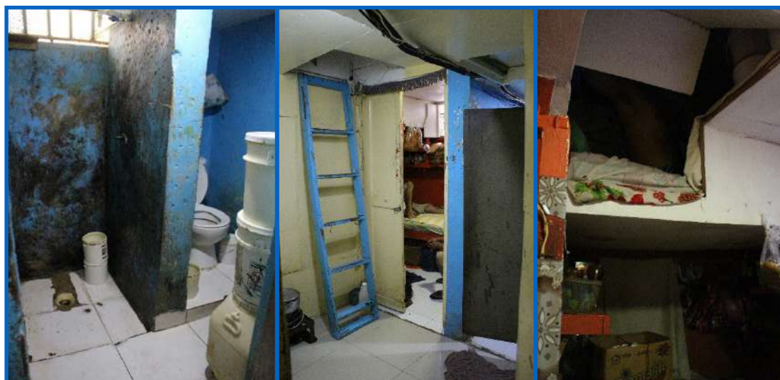
Condiciones de los baños y del interior de las celdas
