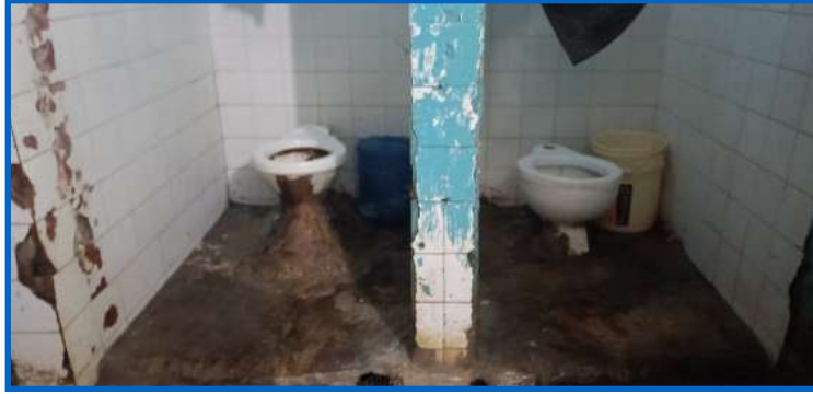
Nótese el mal estado de los baños
