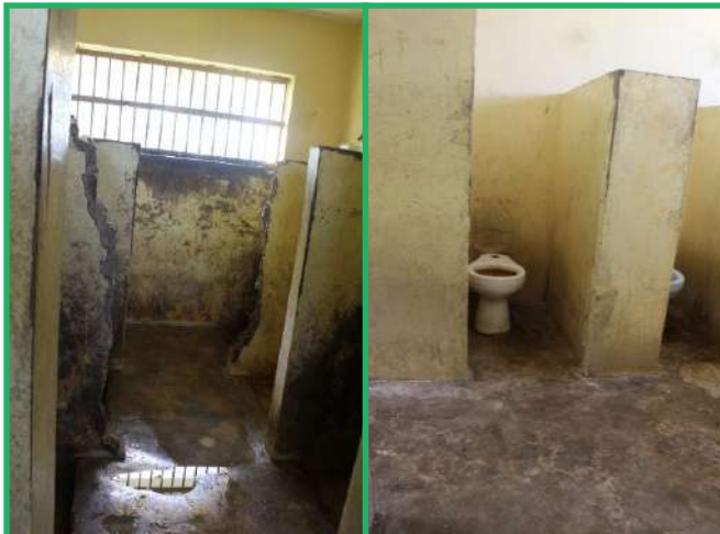
Baño común, se observa la falta de condiciones de higiene de esta área
