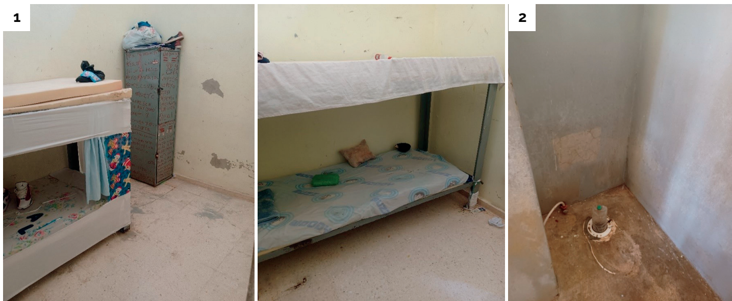
1. Dormitorios internos. 2. Imagen hoyo donde los internos hacen sus necesidades fisiológicas por falta de inodoro.
