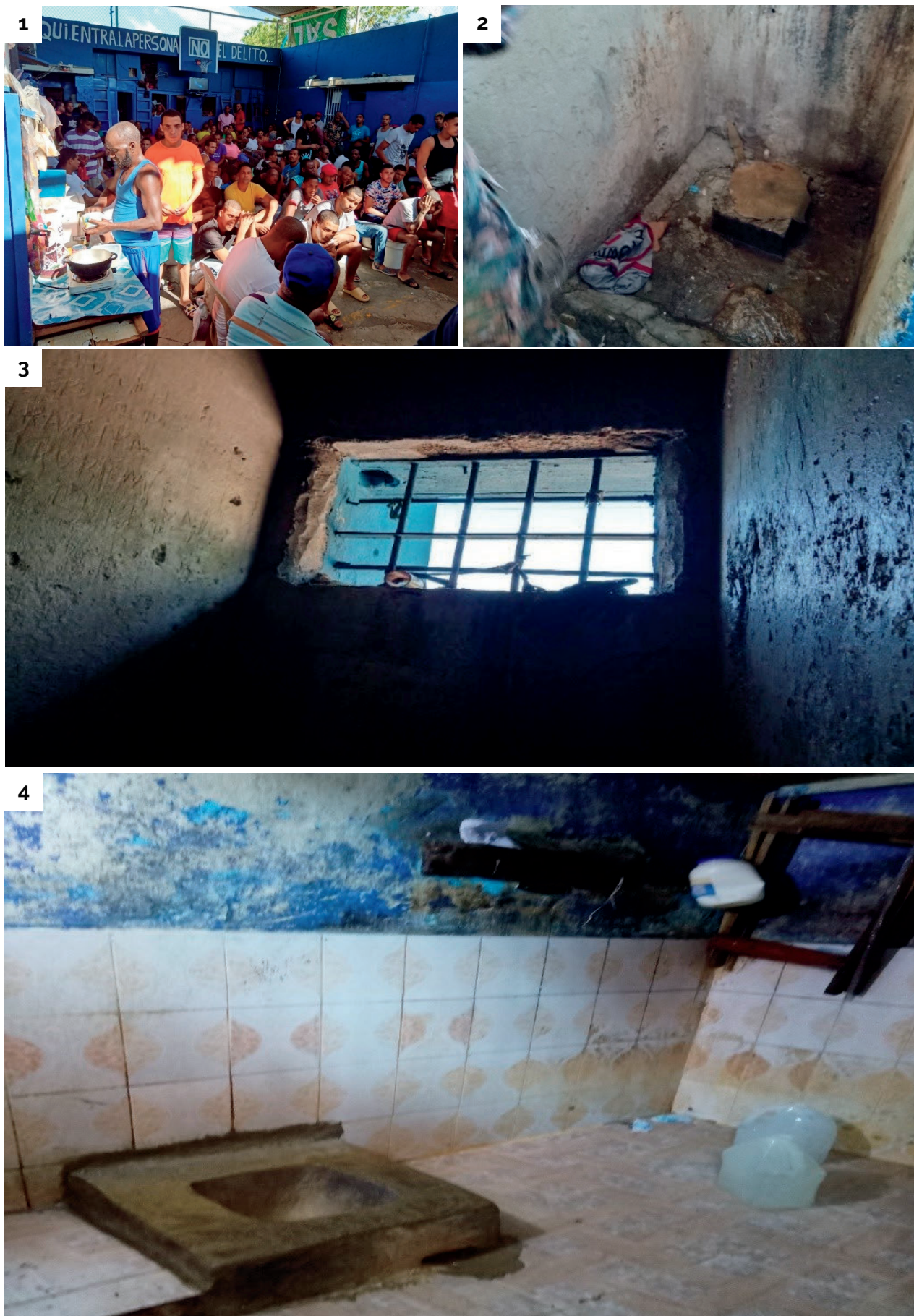
1. Como puede verse en el área común, los internos están aglomerados debido a la falta de espacio. 2. Estado de uno de los baños del CPL-19 marzo en Azua. 3. Única ventilación de una de las celdas de reflexión. 4. Condiciones de los baños tipo piletas.
