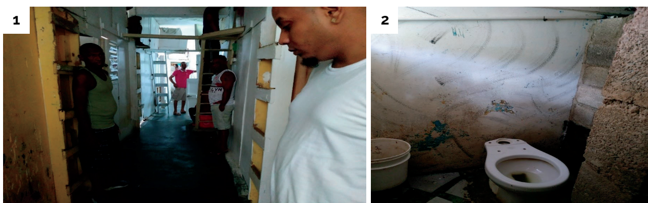
1. Vista de los pasillos, no cuentan con iluminación. 2. Vista de uno de los baños de hombres.
